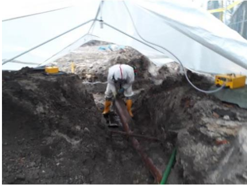
Foto 20: Lostrekken van de gresbuis
