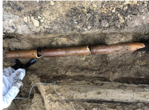
Foto 23: meerdere gebroken mofverbindingen
